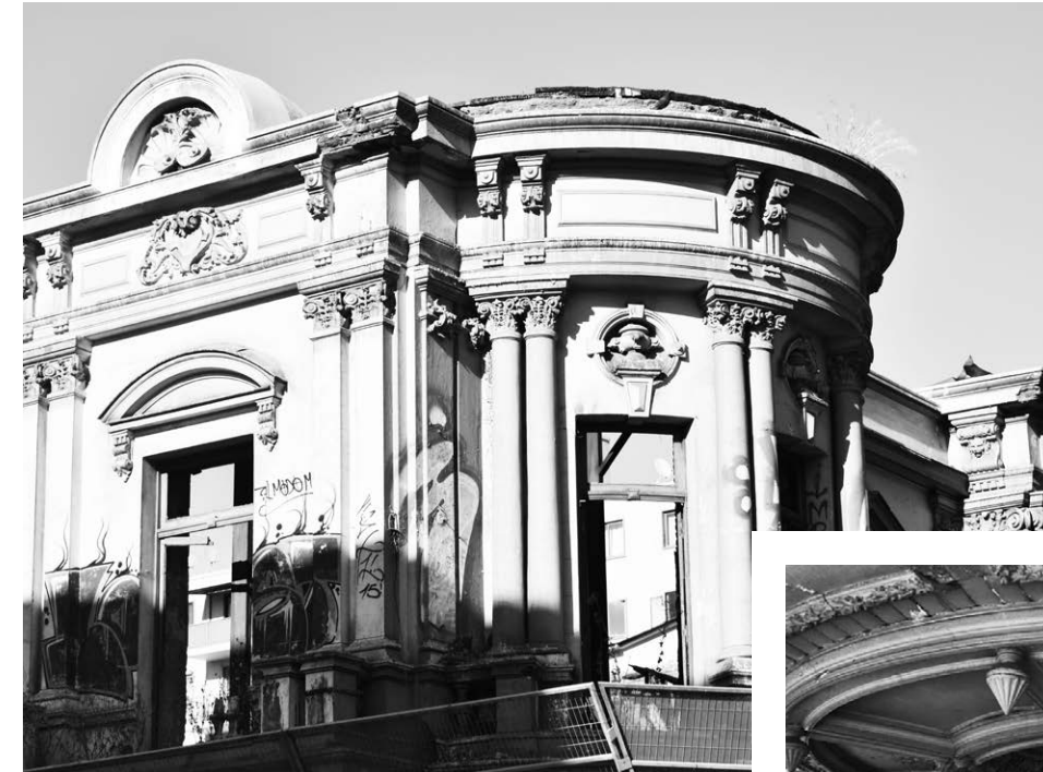
Deterioro actual del edificio.
